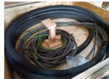
Service Loop - power 1.jpg
